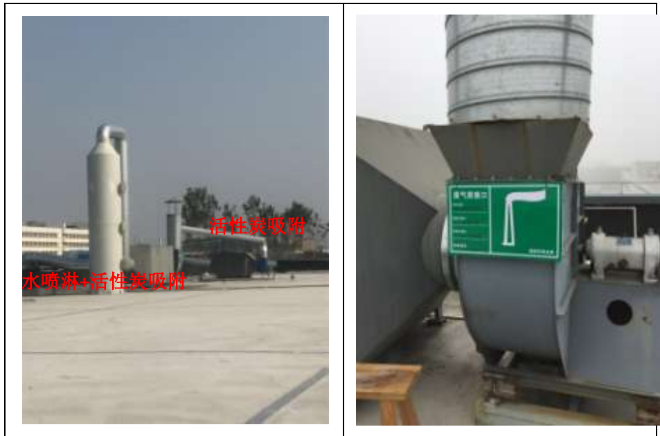
图 4.1.2-2 废气处理设施现场照片
