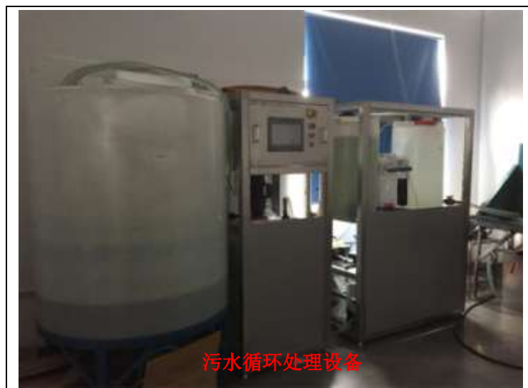
图 4.1.1-2 污水处理设施现场照片
